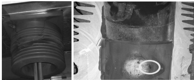
(a) 热熔引起悬浮 (b) 高压引线悬浮造成套管炸裂
